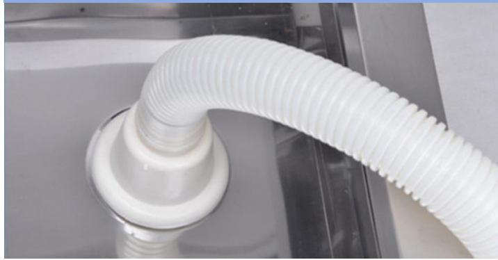
排水管道：韌性好，不易變形
